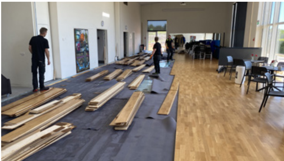
Gulvet i salen fik store skader. Foto: Henrik Poulsen
